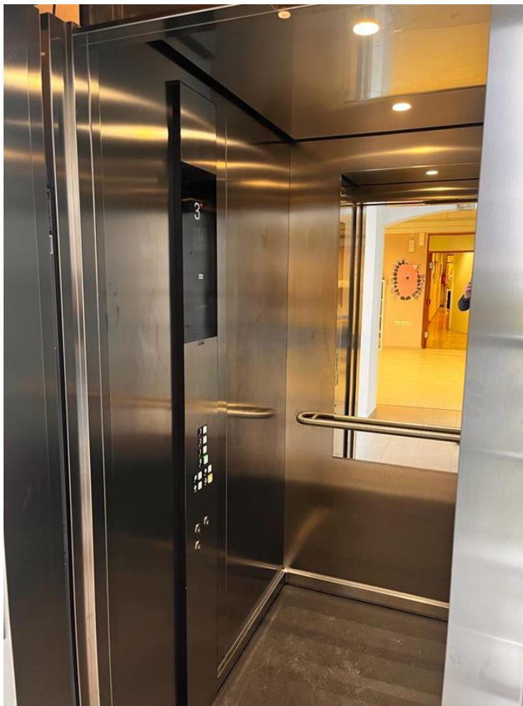
Slika 18: Kabina ugrađenog dizala
