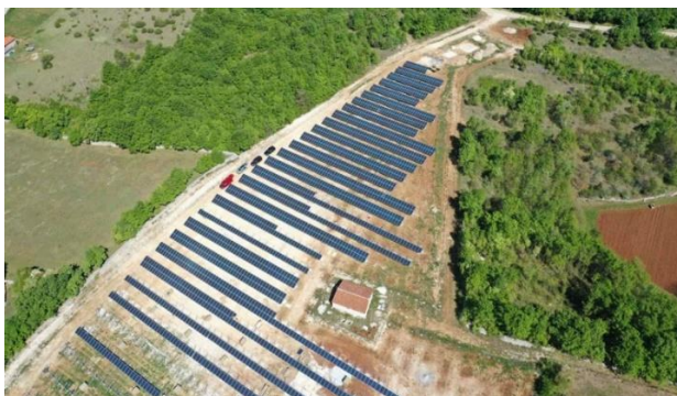
Slika 4.6. Solarna elektrana Marići
