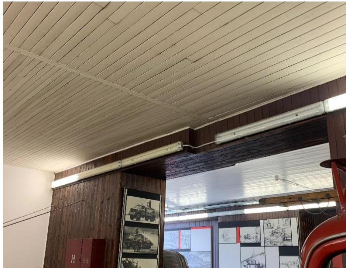
Fotografija 5. Neispravna rasvjetna tijela
