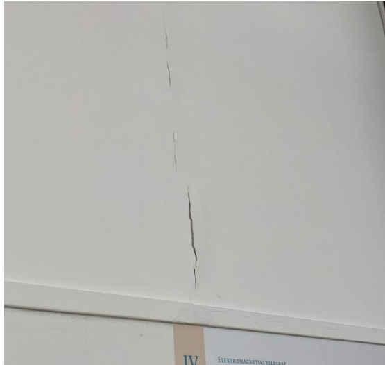
Fotografija 1. Pukotine na zidu
