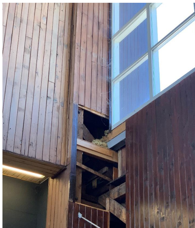
Fotografija 4. Rupe u zidu i paučina
