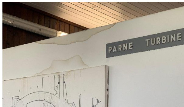
Fotografija 2. Mrlje na pregradnim zidovima
