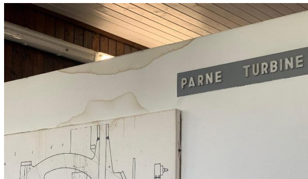
Fotografija 2. Mrlje na pregradnim zidovima
