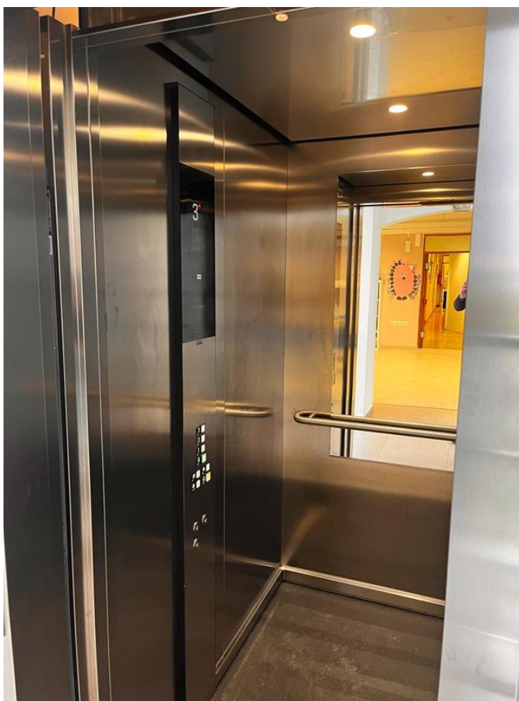
Slika 18: Kabina ugrađenog dizala
